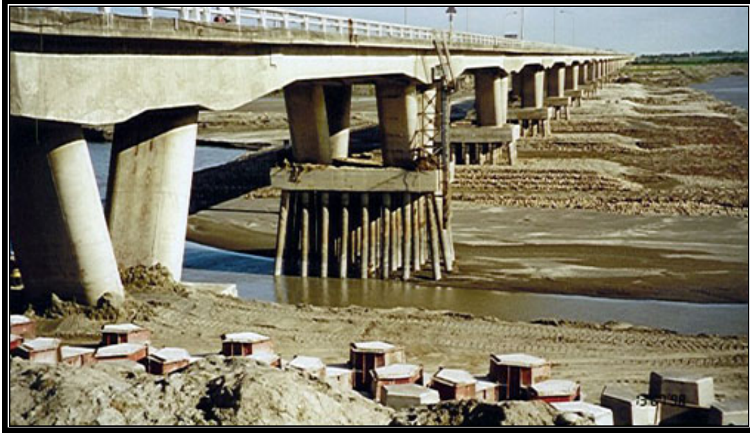
Rajah 2.1 : Keruk pada jambatan di New Zealand (Melvin and Coleman,2000)
