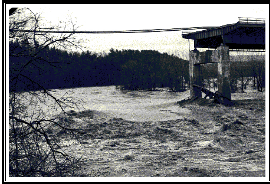
Rajah 1.6 : Runtuhan yang berlaku pada jambatan Schoharie Creek (USGS 1987)
