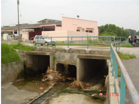
Foto 1.7 - Bentuk kelubung jenis 'Triple Box Culvert' yang menyekat sampah dan menghalang aliran air di CH 2600
