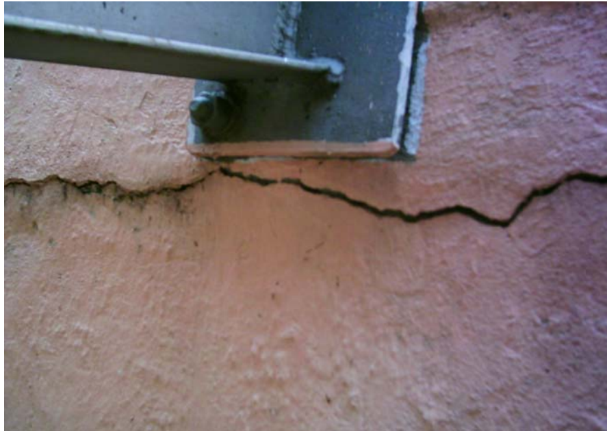
Gambar 2.3 : Keretakan akibat bebanan lebih
