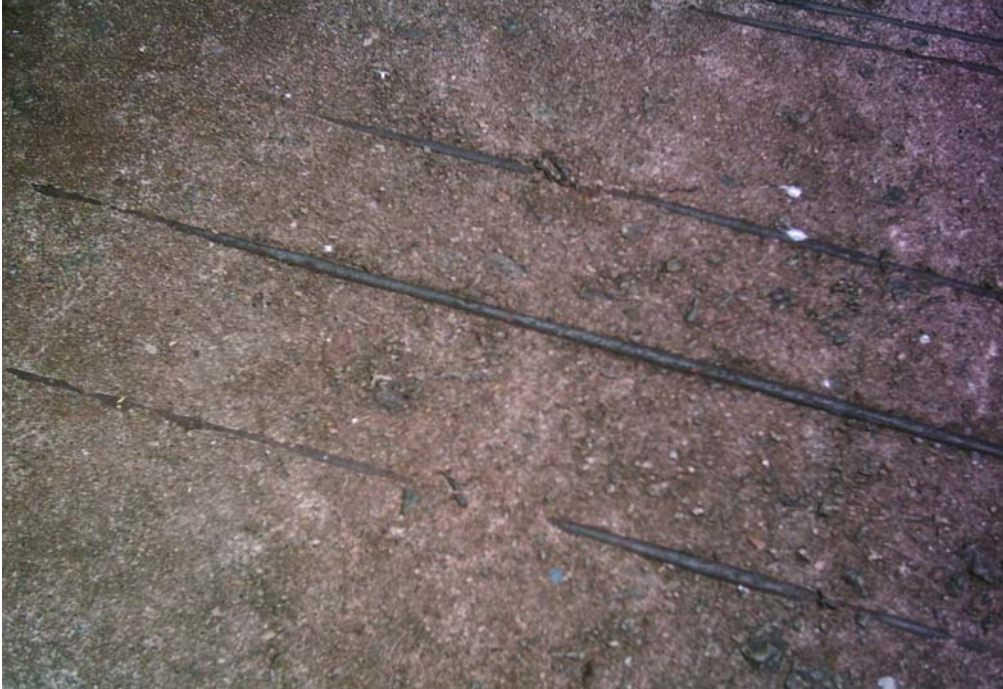
Gambar 2.2 : Pengaratan besi tetulang akibat hakisan
